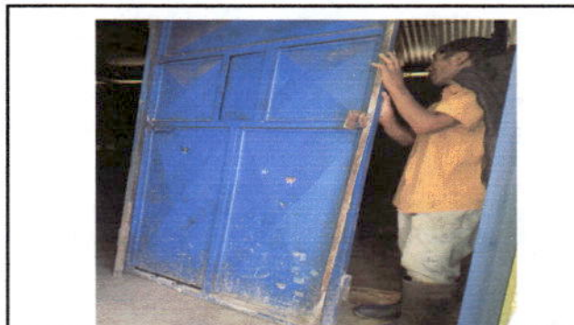
Foto 4: Desinstalación de la puerta de la cocina que está en mal estado.
